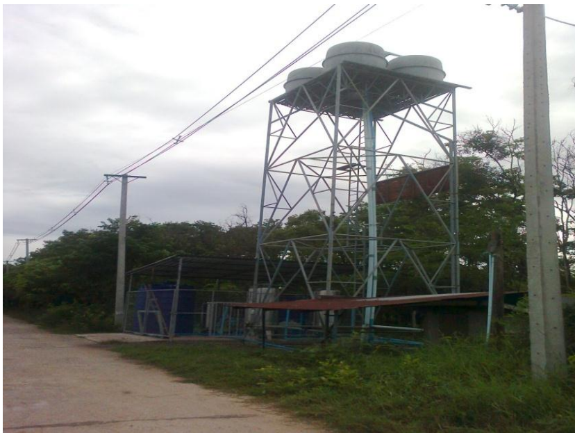
รูปที่ 1.1 ระบบประปา บ้านหนองเชียงชา หมู่ที่ 8
